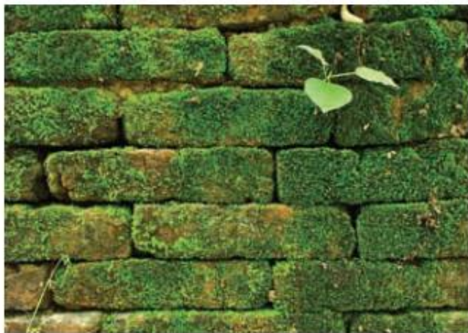
Muro coberto por musgos.
